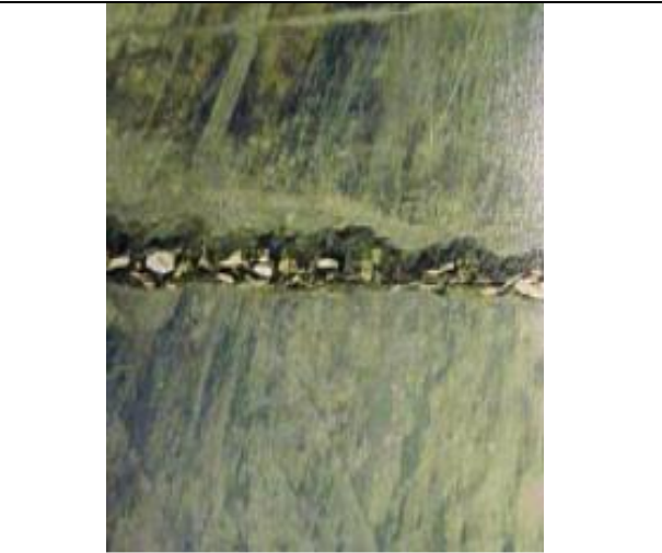
Rys. 22. Częstą formą przeciążenia jest występowanie spoin na krawędziach płyt.
