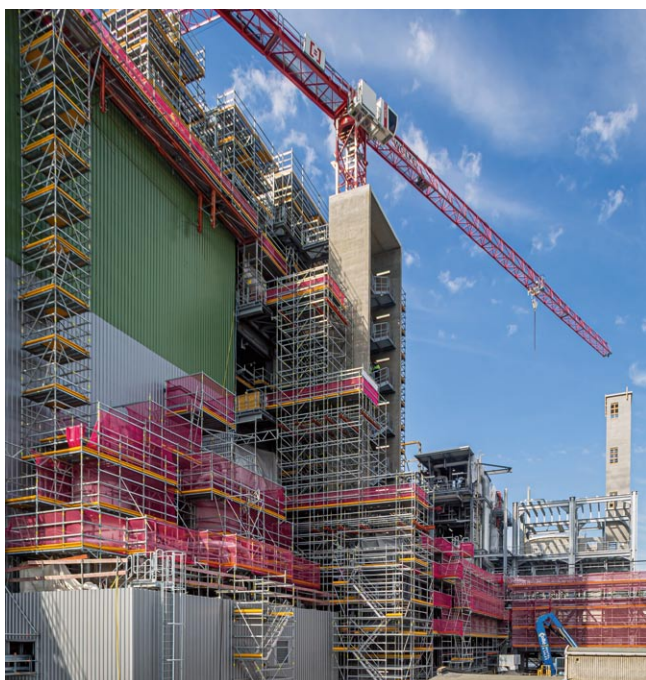
Rys. 3. 30-metrowa wieża podporowa o dużej wytrzymałości i konstrukcja mostowa po północnej stronie budynku
