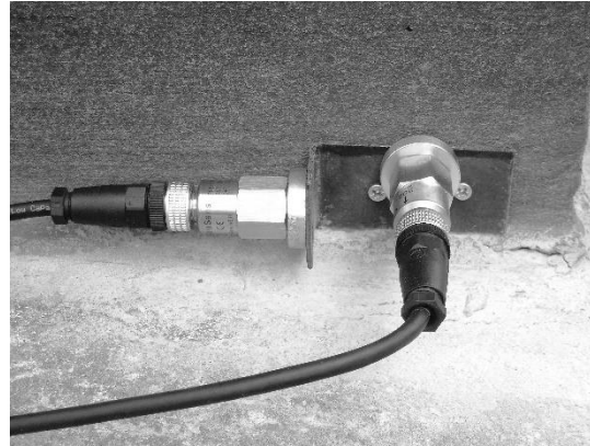
Rys.2 Czujniki pomiarowe zamontowane na ścianie budynku mieszkalnego
