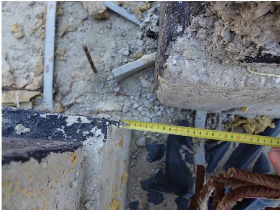
Zmniejszenie przerwy dylatacyjnej z projektowanej 10cm do 6,5cm
