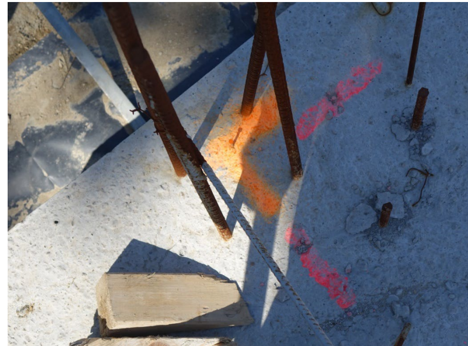
Przesunięcie osi konstrukcyjnych: pomarańczowy – pierwotna, różowy - przesunięta
